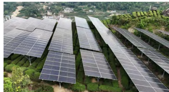
宜昌市秭归县九畹溪 100MW 茶光互补光伏电站，在生产清洁电力的同时，有效提升茶树抵御自然灾害的能力
